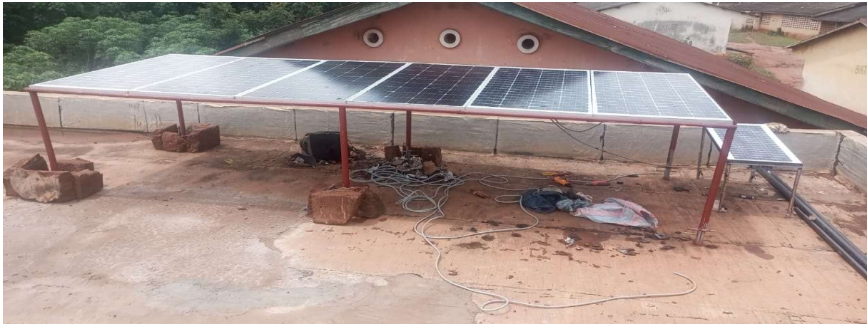
Panneaux solaires pour le château d'eau
